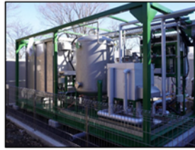
メタン発酵バイオガス発電設備
